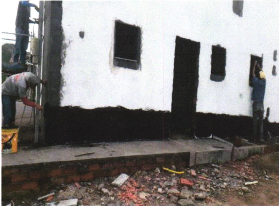
FOTO 21 - IMPERMEABILIZAÇÃO DE SUPERFÍCIE COM MANTA ASFÁLTICA, UMA CAMADA, INCLUSIVE APLICAÇÃO DE PRIMER ASFÁLTICO, E=3MM. AF_06/2018
