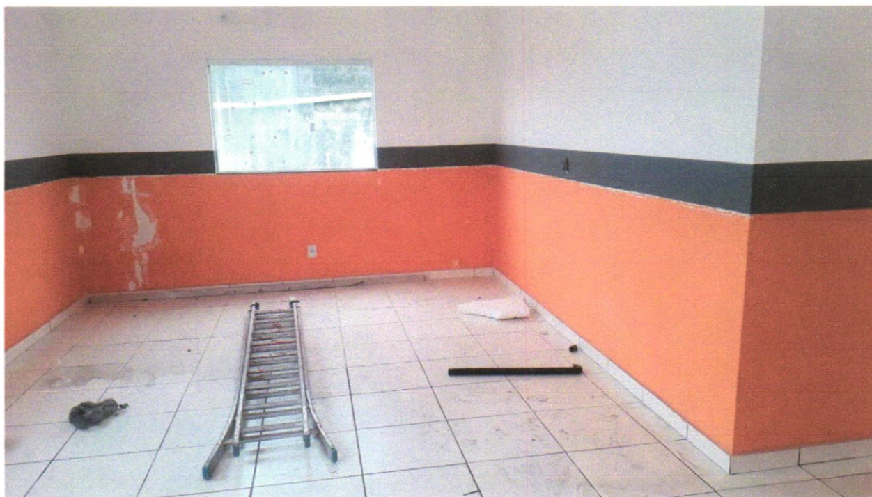
FOTO 31 - APLICAÇÃO MANUAL DE PINTURA COM TINTA LÁTEX ACRÍLICA EM PAREDES, DUAS DEMÃOS. AF_06/2014
